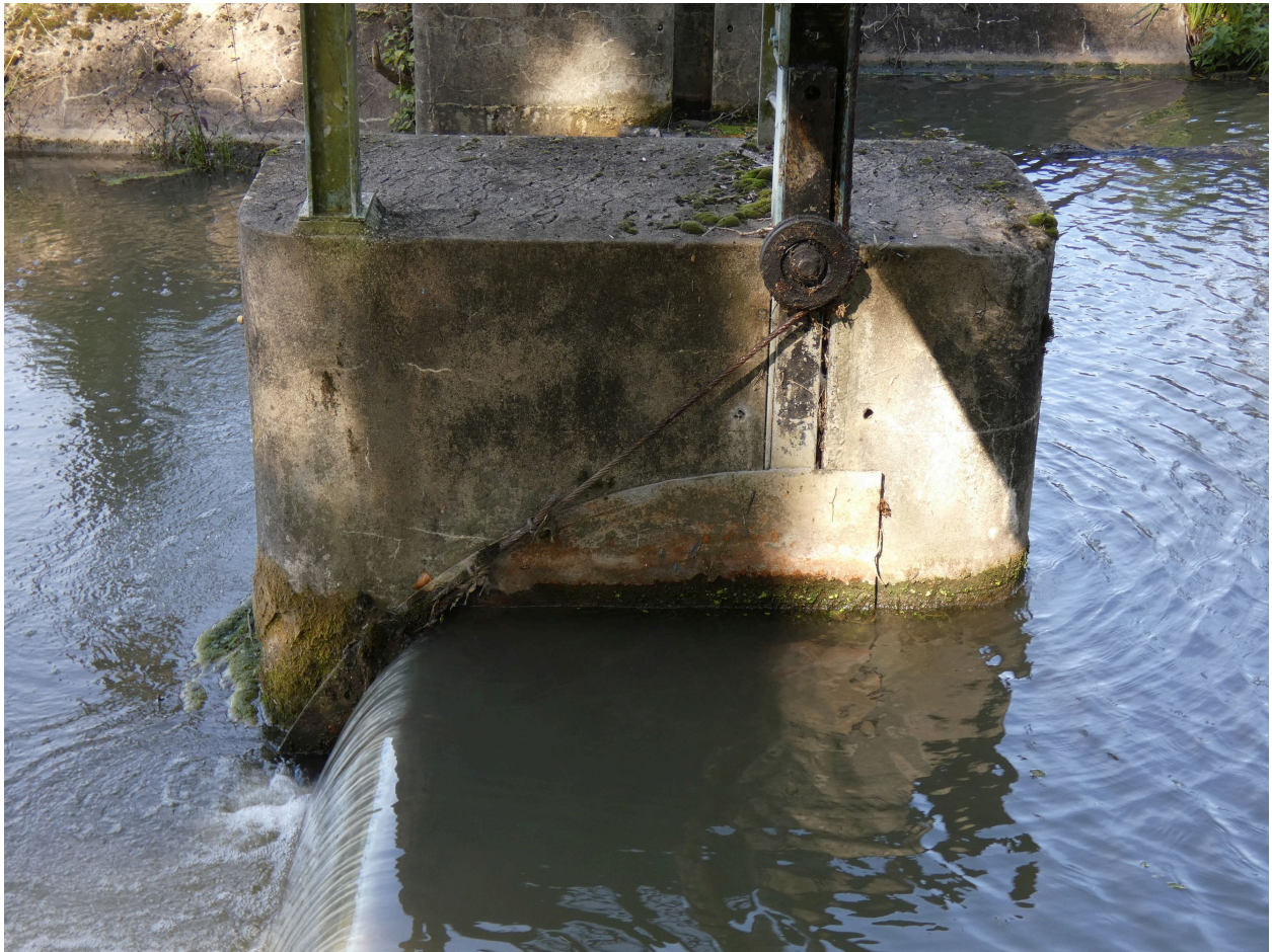
Mécanisme d'une des deux vannes levantes.
