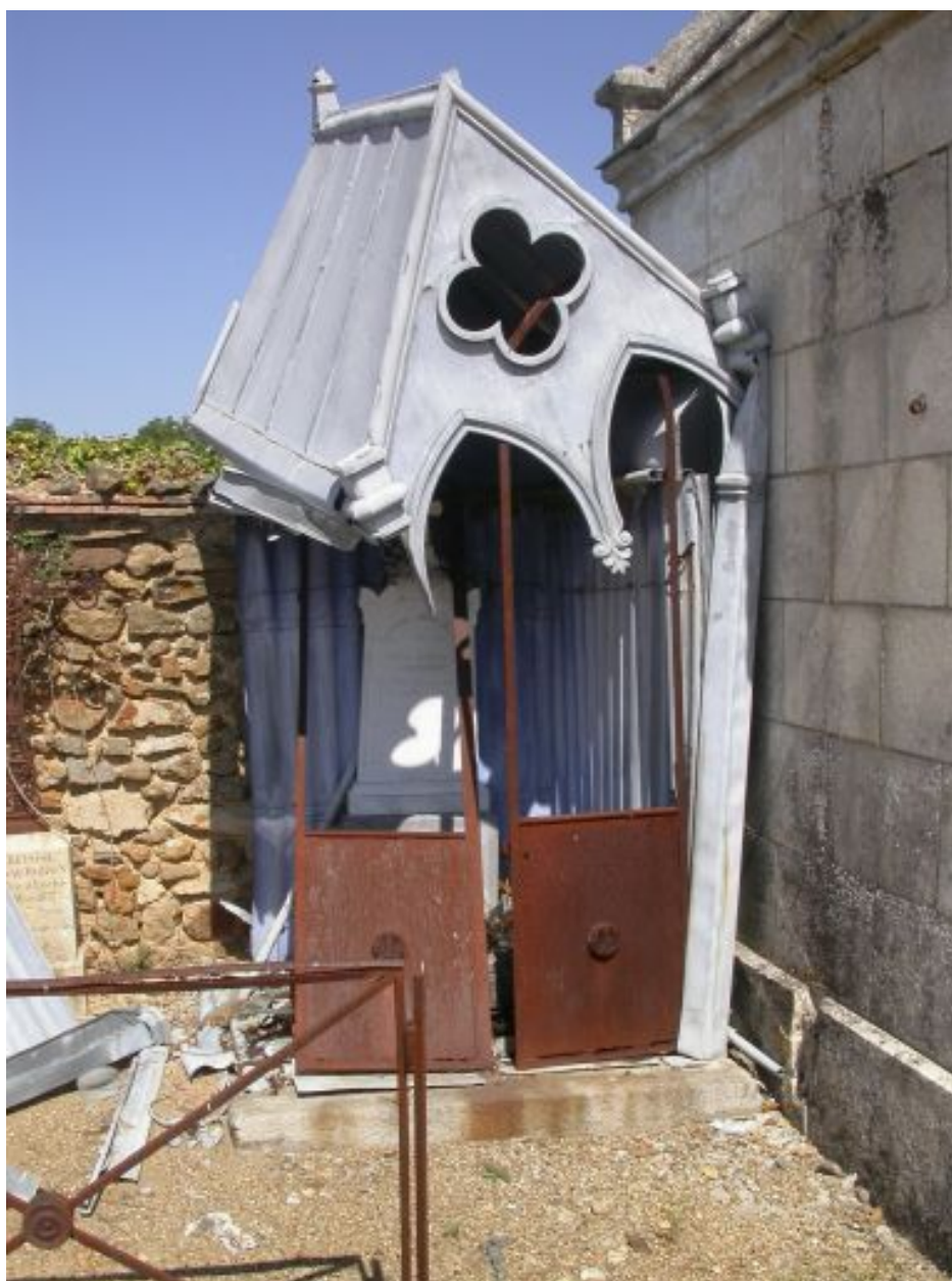
Édicule qui s'effondre.
