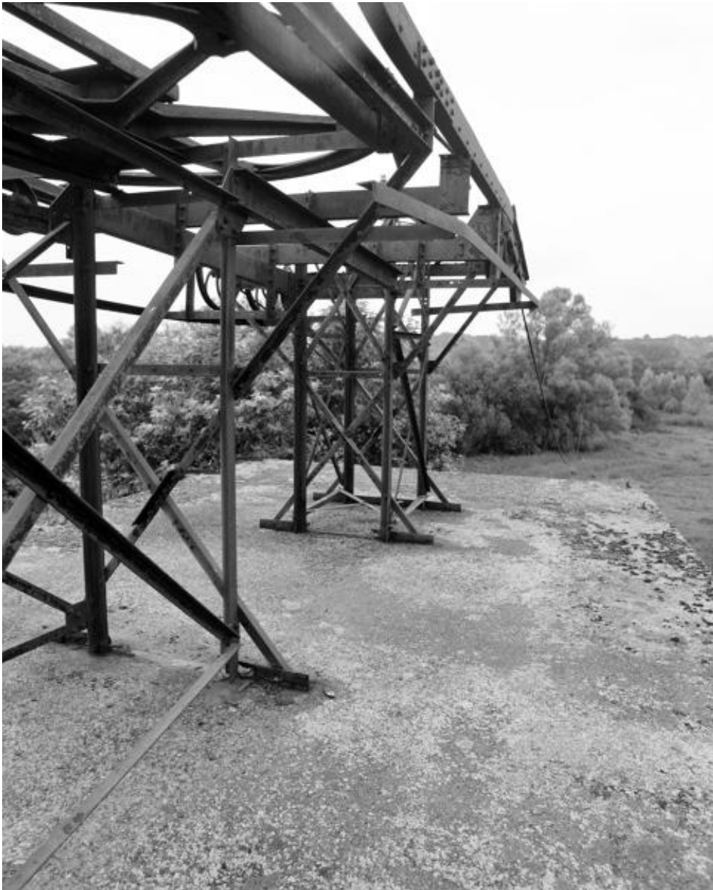
Vue de la jonction entre le câble et le monorail de la station d'arrivée du transporteur automatique (état en 1997).
