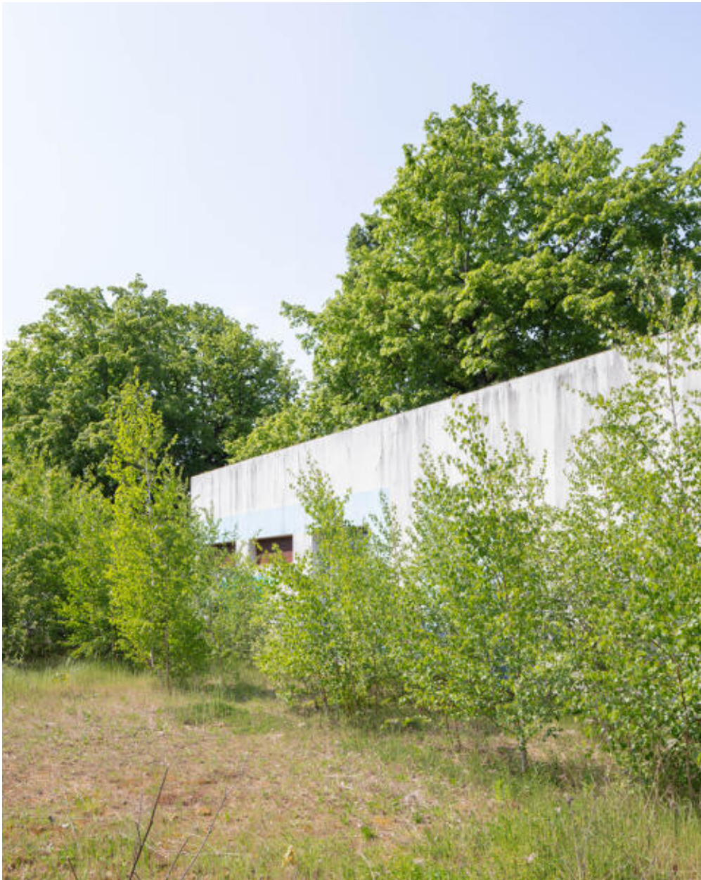
Vue de la façade principale de la structure en dur de la piscine.
