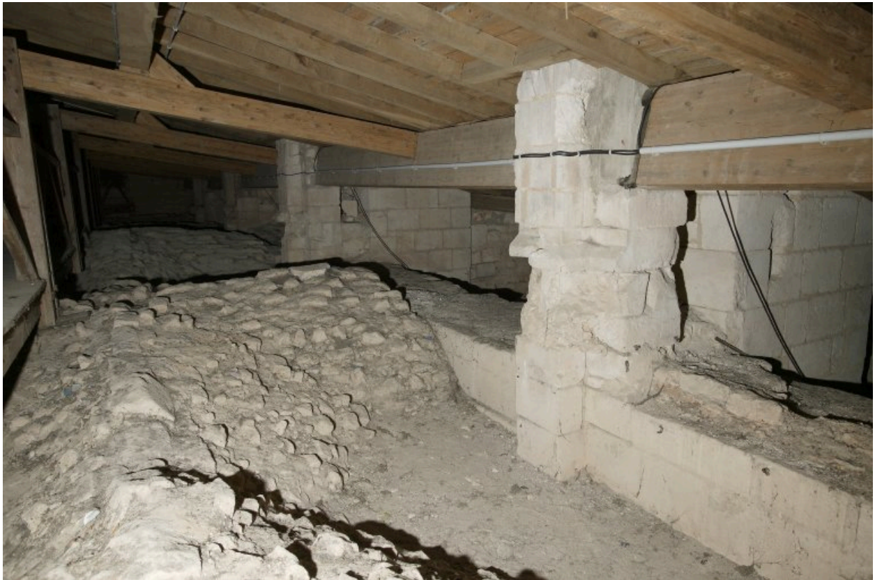
Parties hautes de la façade romane du bas-côté nord : vue d'ensemble prise d'est en ouest, des voûtes du bas-côté.
