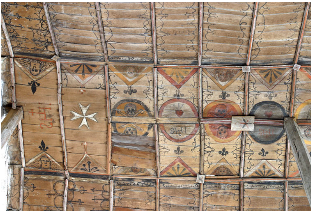
Nef, voûte, côté sud, quatrième travée : vue d'ensemble du registre de faîte.
