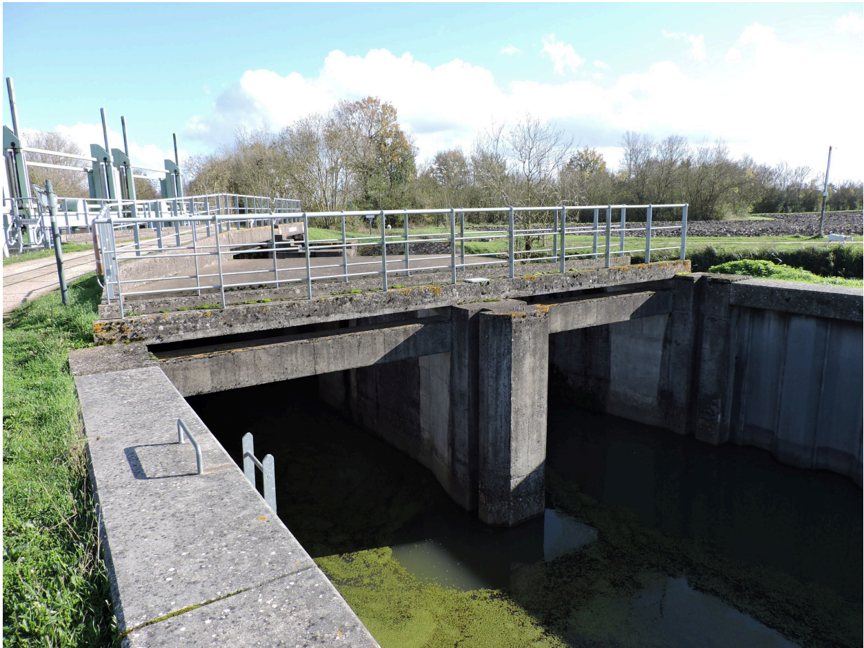
Le canal de Vix ressortant du second aqueduc, à l'ouest, vu depuis le nord-ouest.
