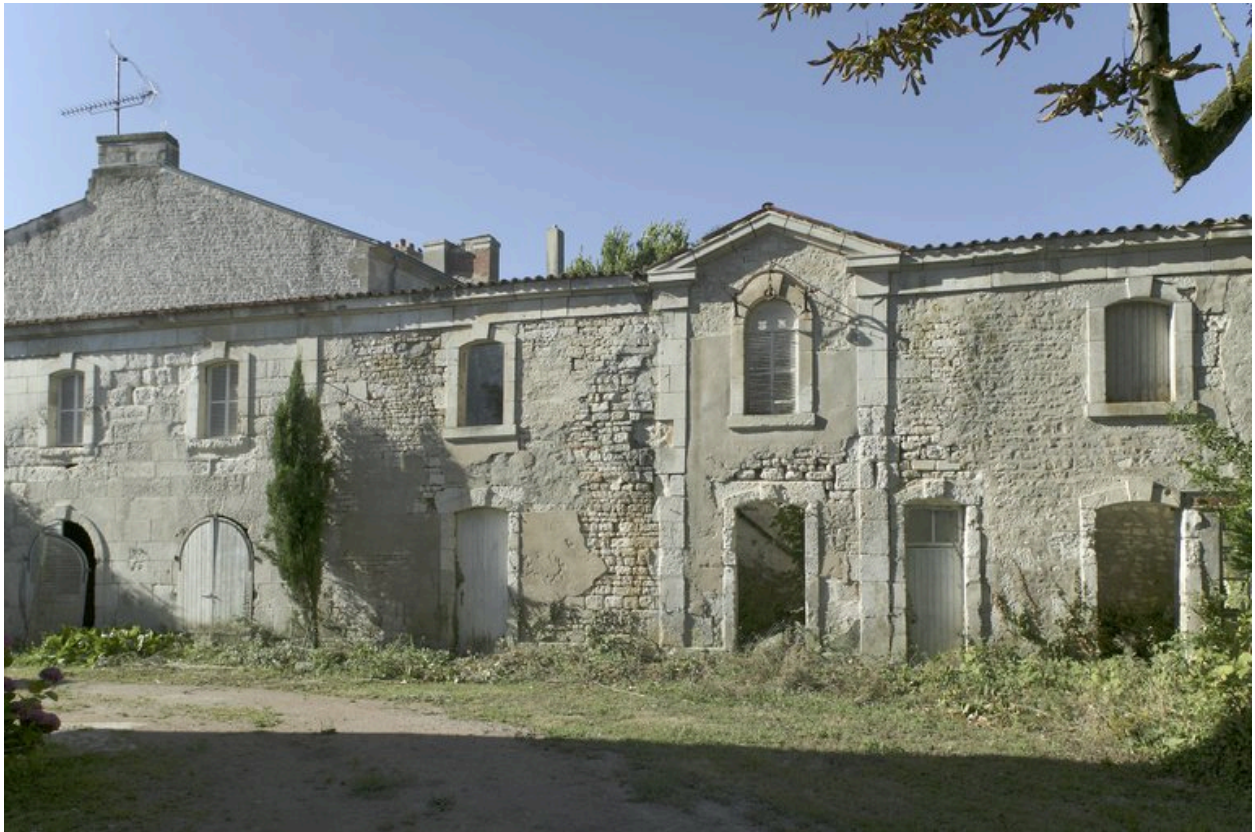
Vue du corps de bâtiment principal des entrepôts, situé au sud de la porte cochère.
