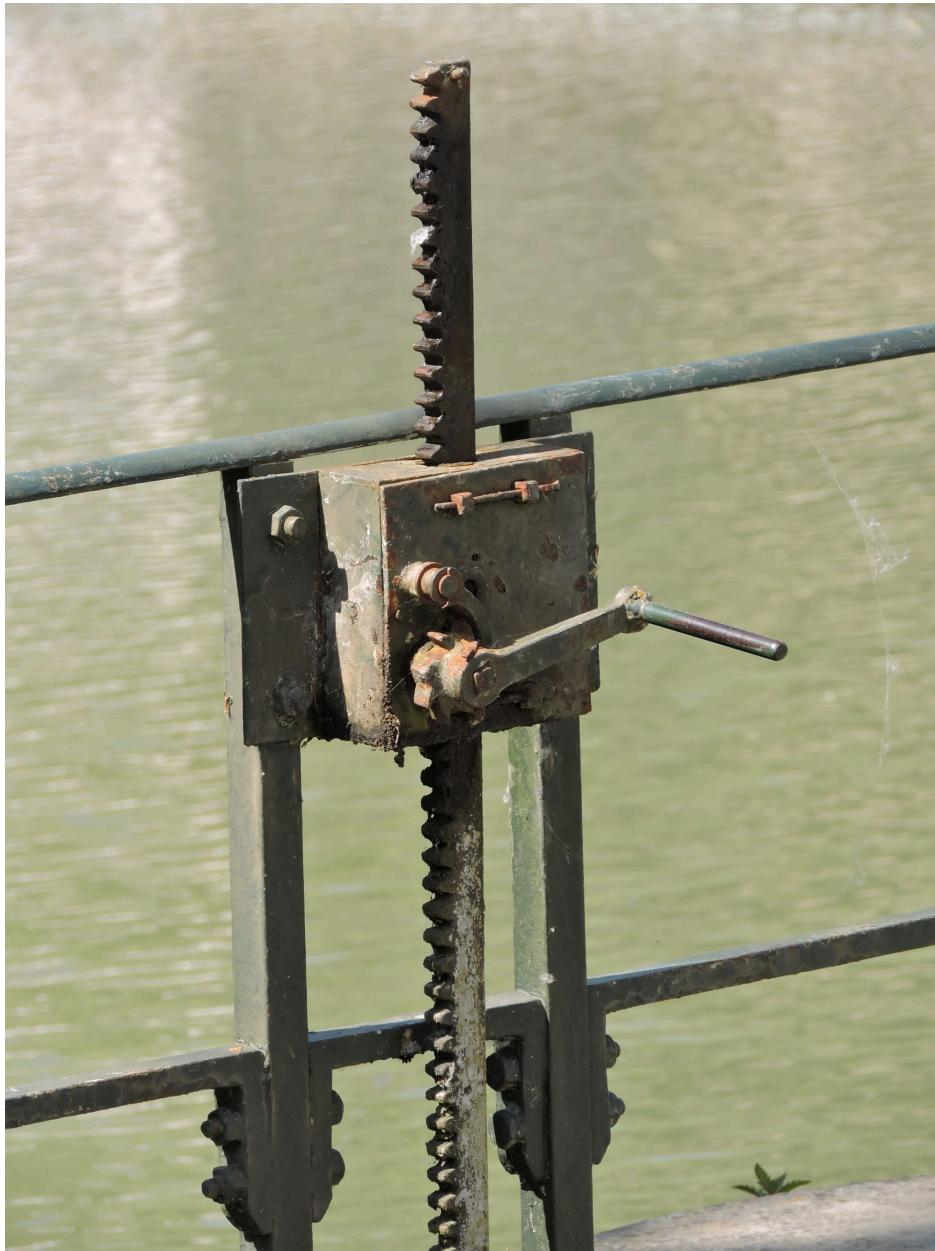
Détail de la porte aval de l'écluse : crémaillère à cric servant à manoeuvrer la ventelle.
