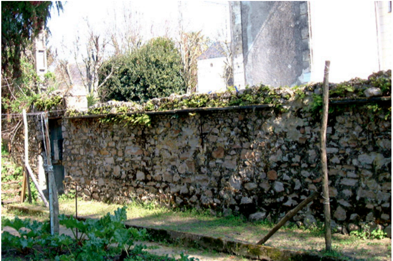
Ardoises en saillie formant support d'espalier sur le mur de clôture du jardin.
