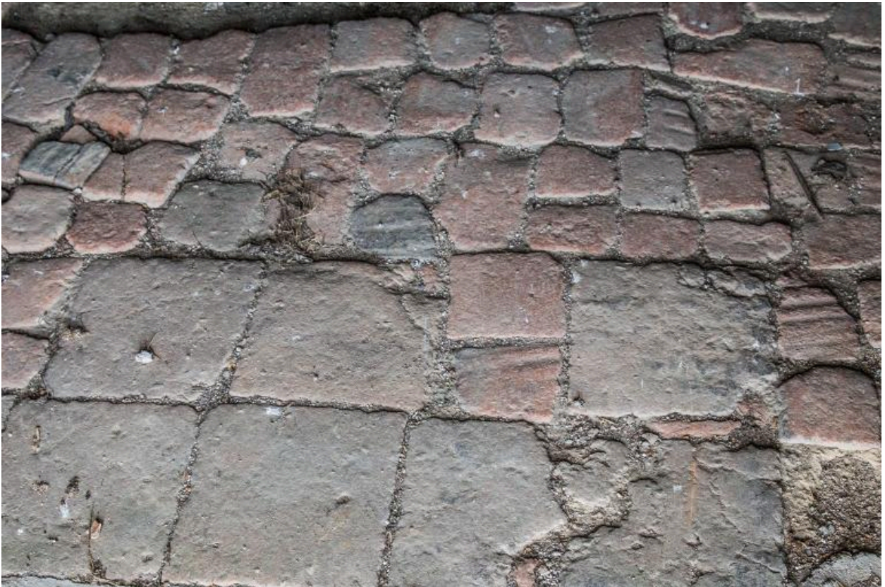
Plancher de grenier pavé de carreaux en terre cuite. L'Anerie, Gétigné, cadastre 2018, AW 01-133.
