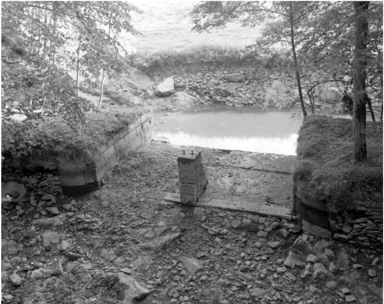
Vannes de décharge.
