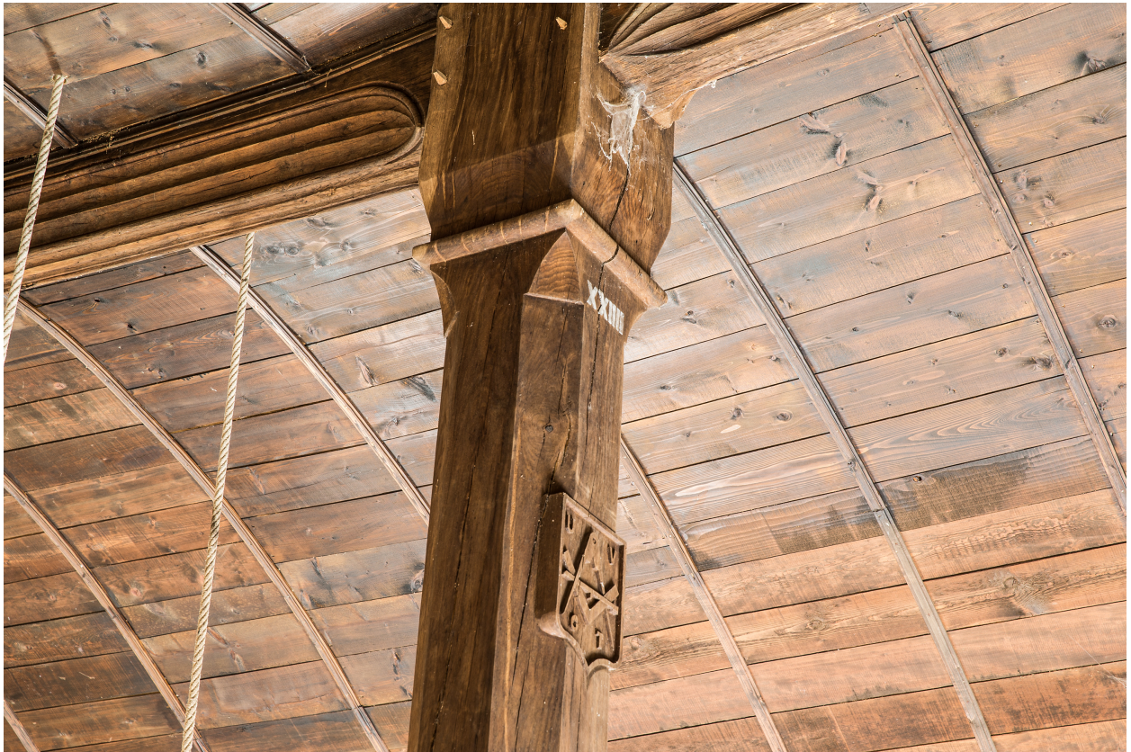
Un détail de la charpente de la nef, le blason des compagnons charpentiers.
