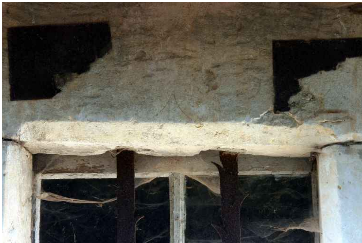
Chambre à feu : linteau de la fenêtre.
