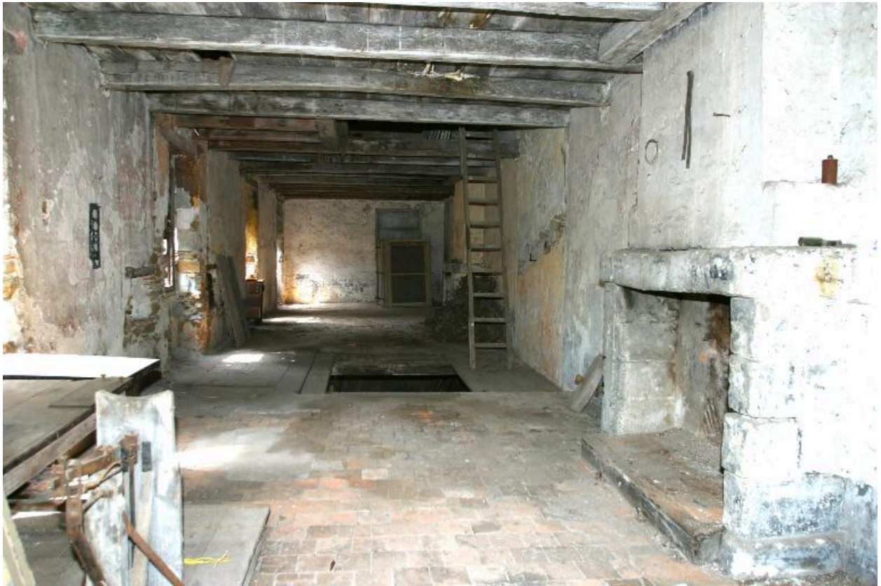
Vue d'ensemble du premier étage vers le nord, au centre, la trémie de l'escalier.
