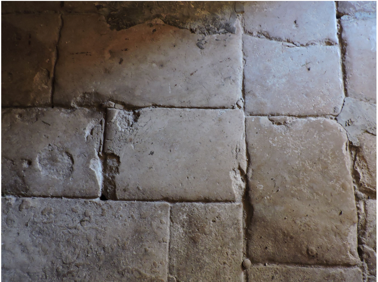
Pavement en pierre de taille dans la pièce de service à l'ouest du logis.
