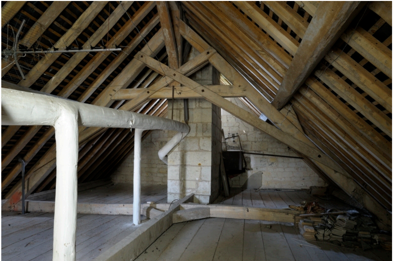
Corps ouest, intérieur, comble : charpente moisée du XIXe siècle et tirants.
