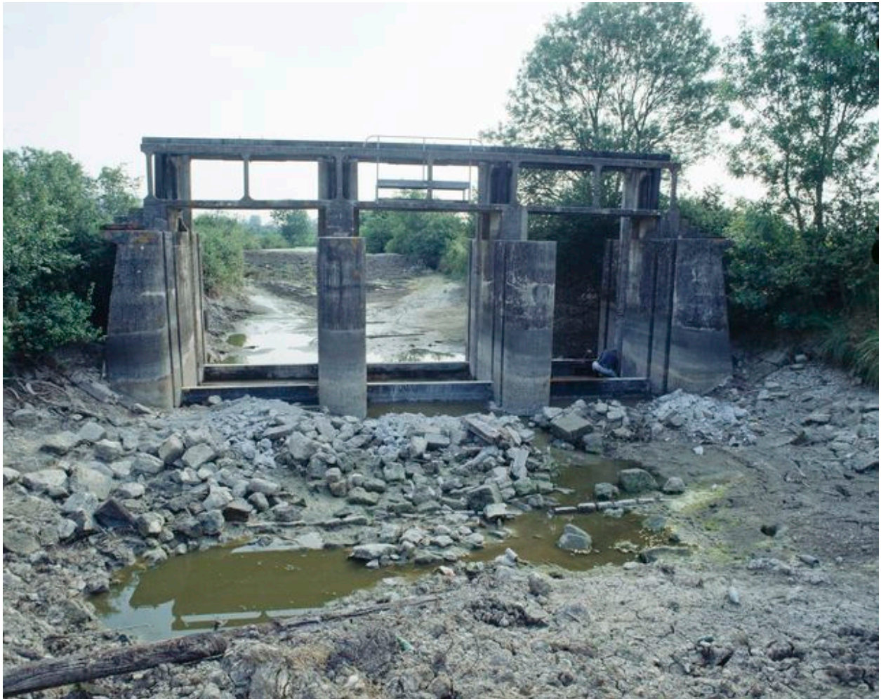
Vue, prise en 1999, de l'ouvrage moderne sans ses vannes et des fondations de l'ancien barrage à poutrelles.
