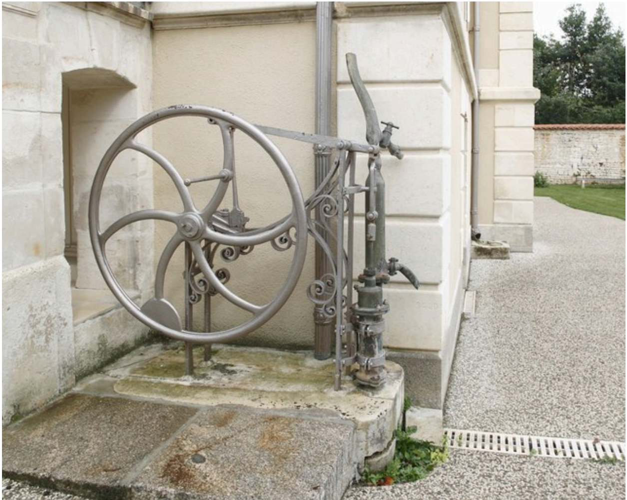
Pompe, près de la façade arrière.
