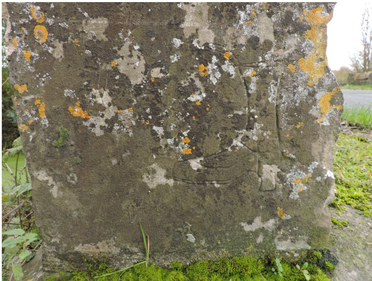
Vestiges de graffiti sur le parapet sud-est du pont, côté nord.
