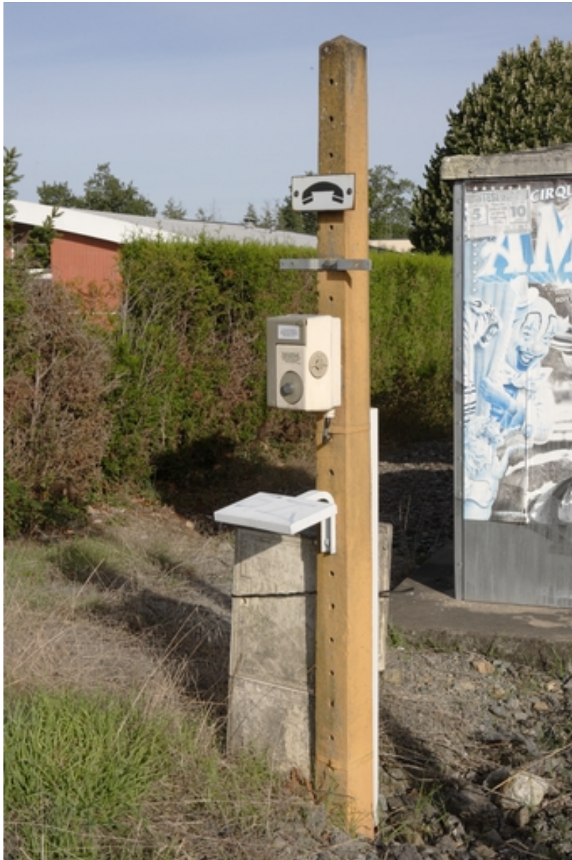
Téléphone et mât béton, PN 313 bis, 2ème moitié du XXe siècle.
