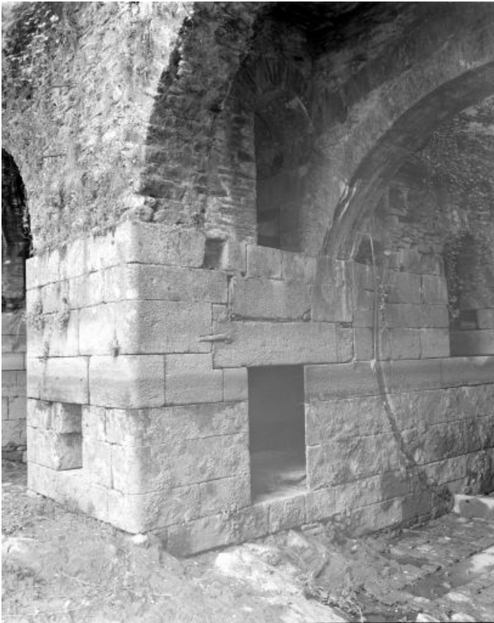
Entrées des coursiers depuis le nord-est. Vue de détail sur le bajoyer sud du coursier nord, les ouvertures du coursier central et le guide de la vanne.
