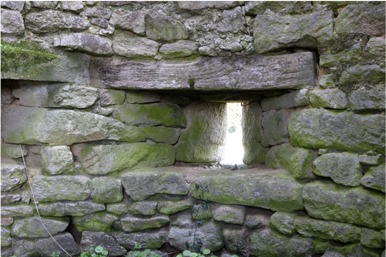
Portail d'entrée. Tour nord. Détail d'une embrasure de tir de la tour nord du portail d'entrée.
