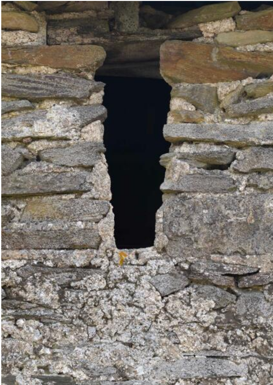
Détail d'une ouverture en moellons de schiste du mur ouest de l'étable, Touche Fleury.
