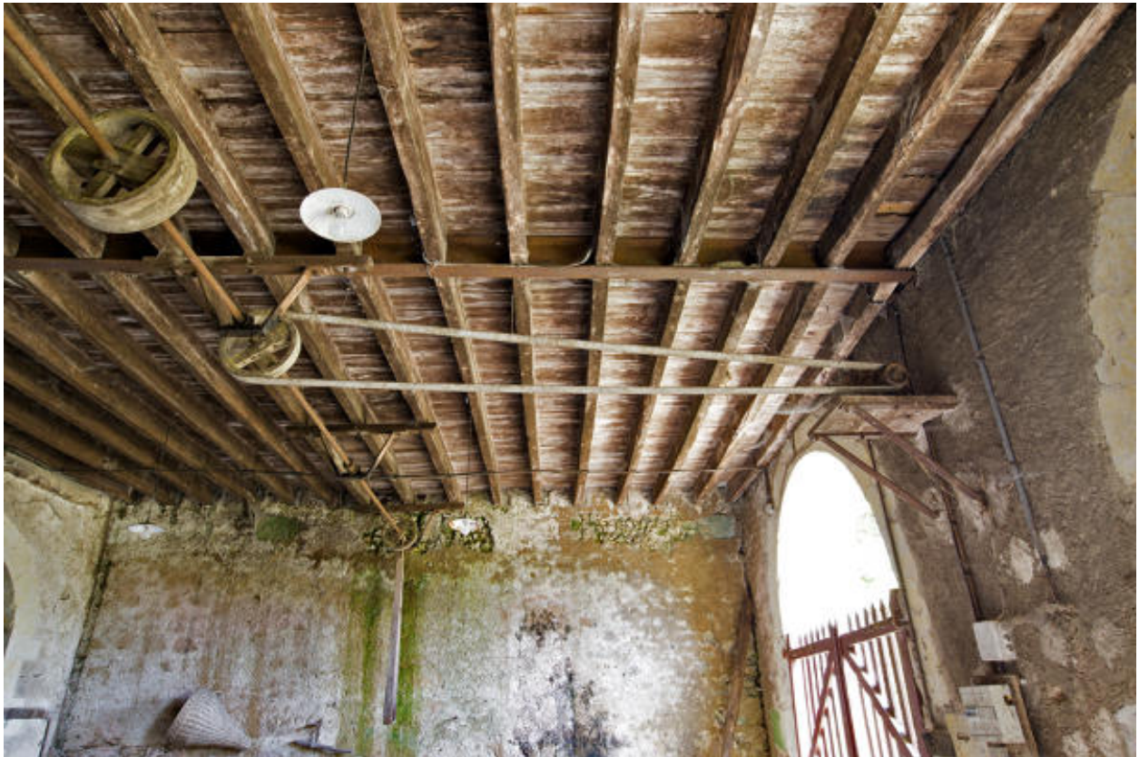
Lhomme, la Richardière, chai : mécanismes de transmission au plafond.
