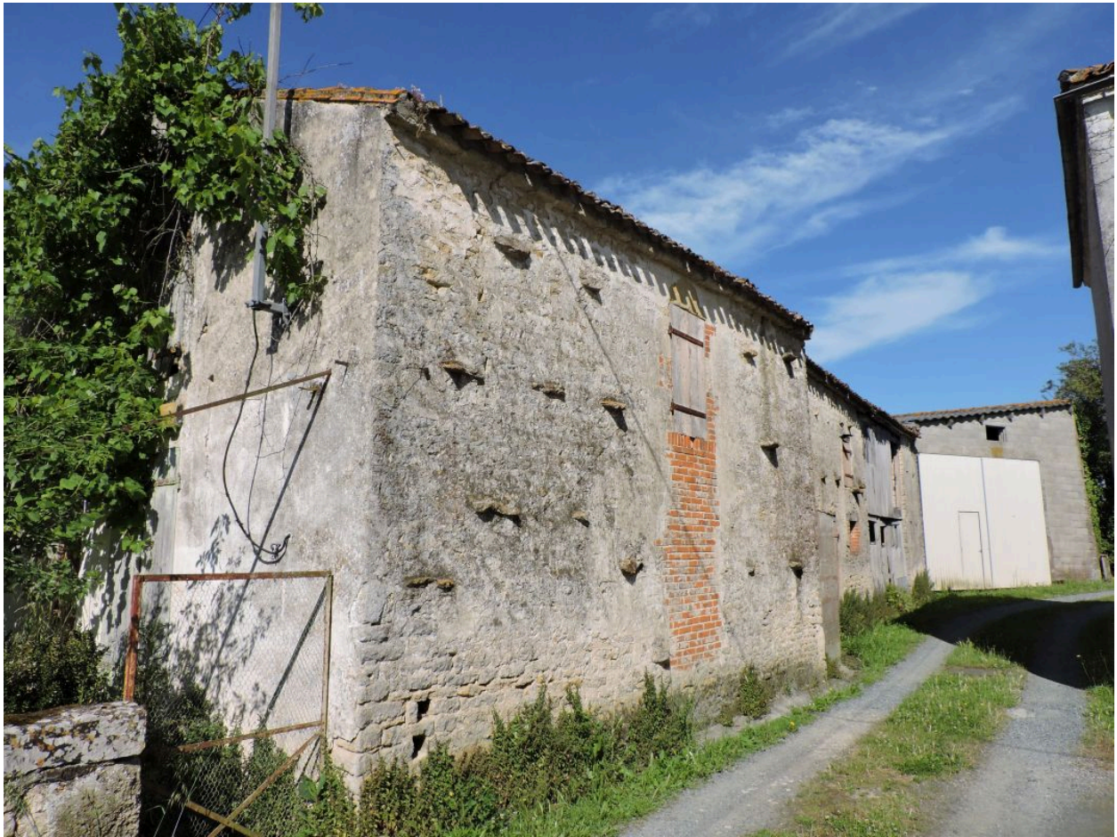
Le petit logement au sud du logis, transformé en dépendance, vu depuis l'est.
