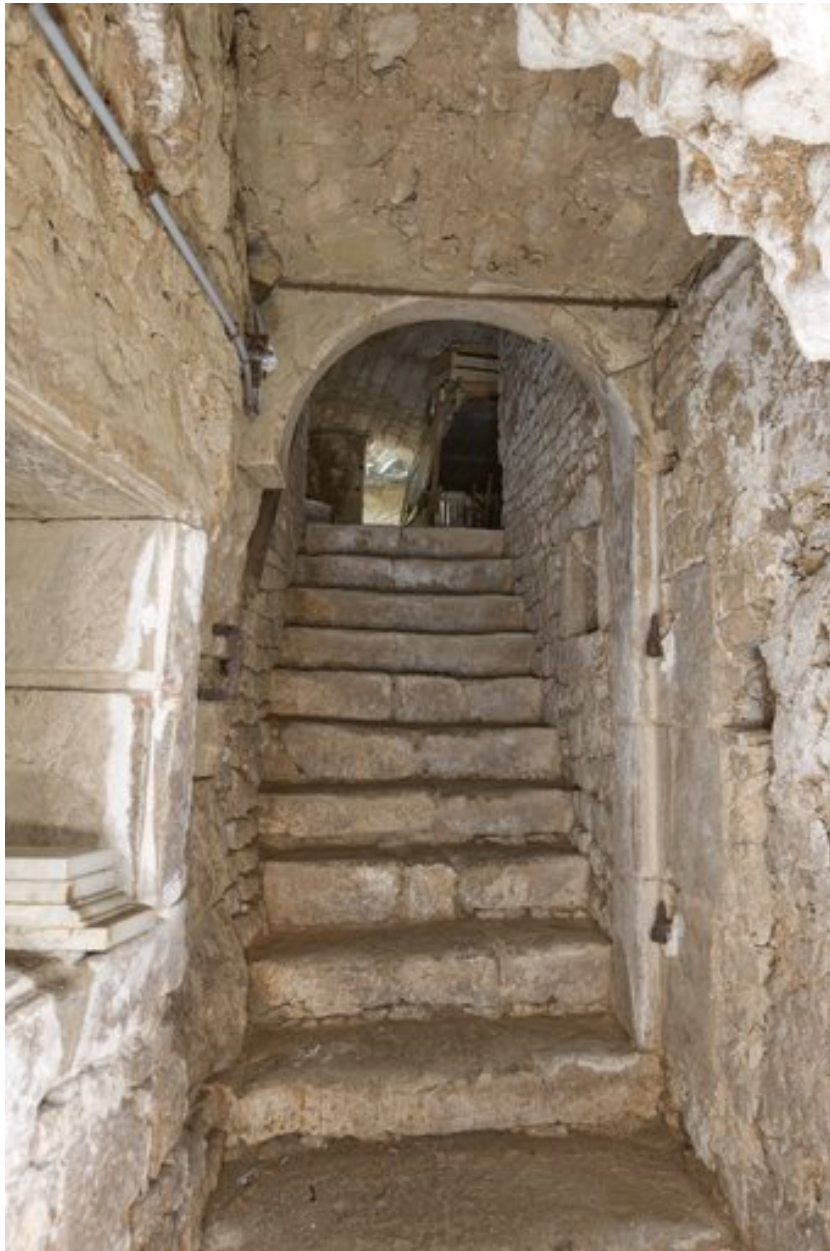
Vue prise du deuxième niveau de sous-sol, en direction de l'escalier de descente.
