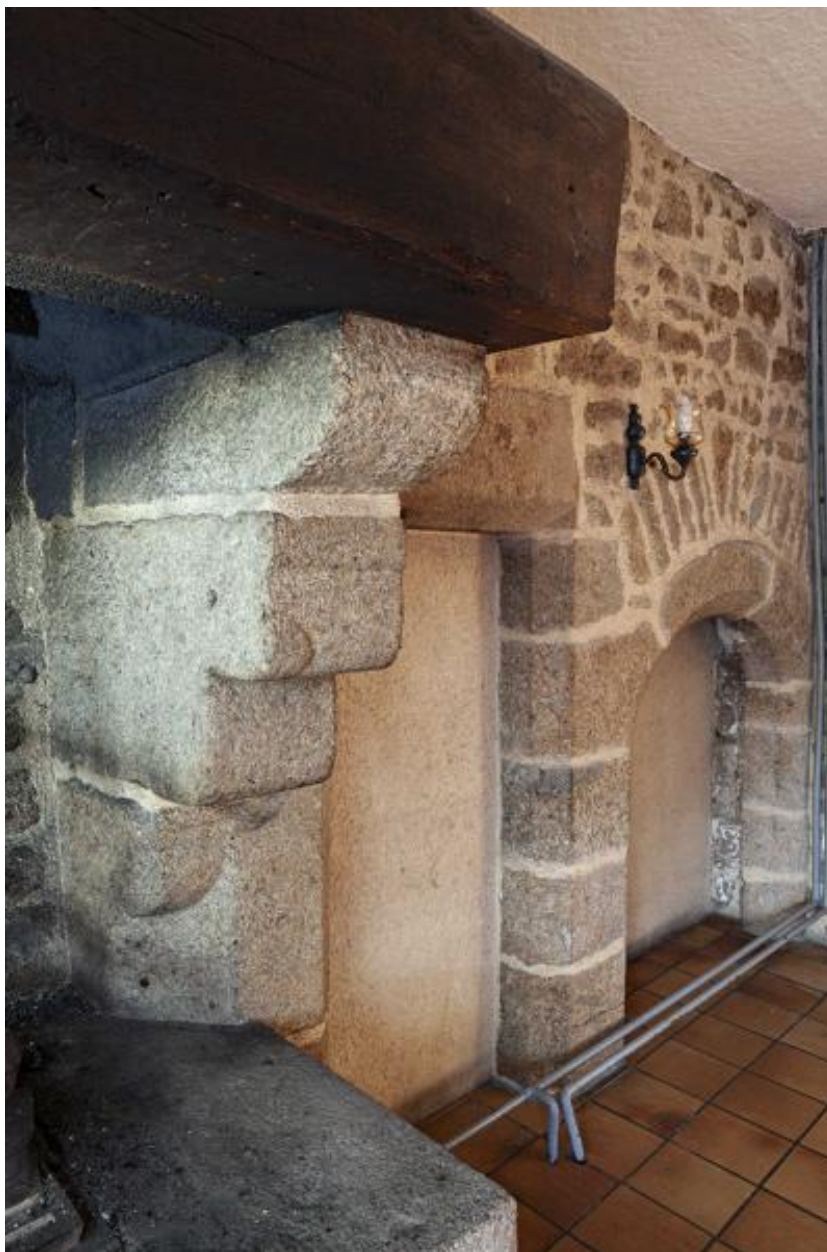
2-4 place du 8-Mai-1945, corbeau droit du mur de refend.
