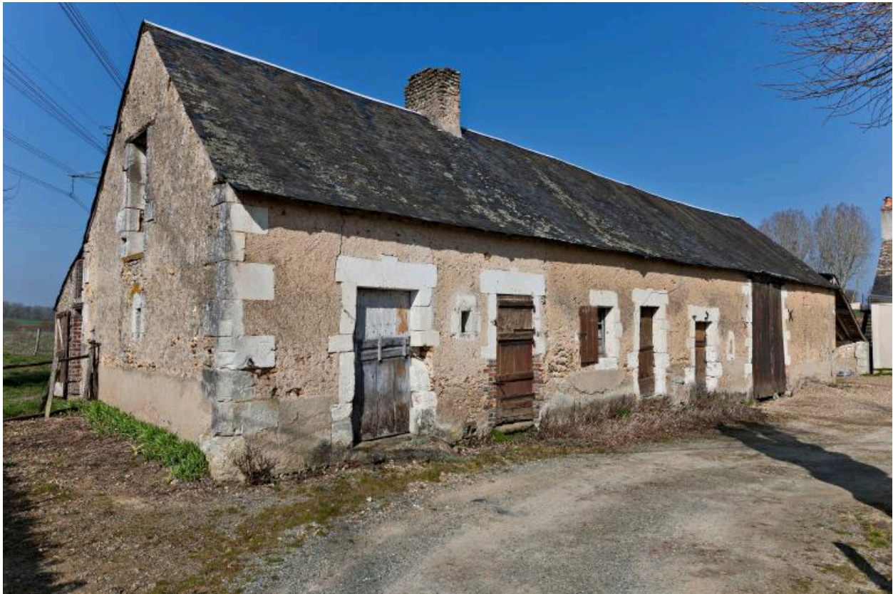
Vue de volume de la ferme bloc à terre (orientée au sud).
