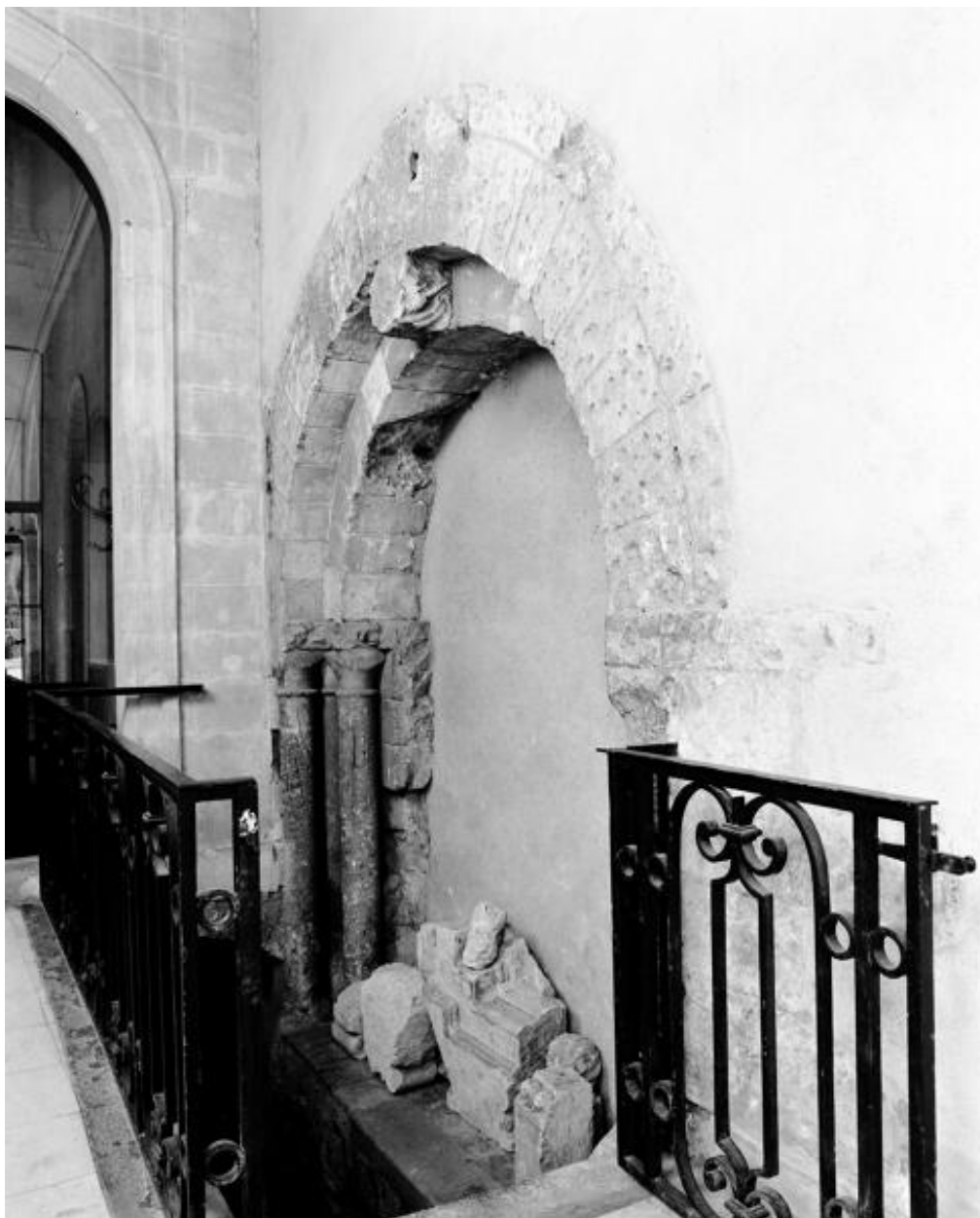
Aile occidentale de l'abbaye, mur oriental, porte murée desservant au XIIe siècle le cellier (actuellement vers la salle des hôtes) : élévation extérieure, sur le cloître.
