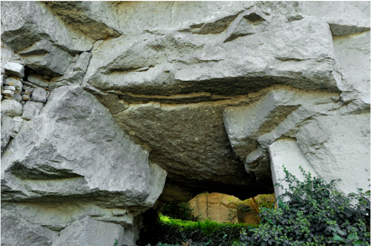
Site principal (11-16, ruelle des Perreyeurs). Fontis ouest. Détail de l'entrée de la carrière de la Maumènière.
