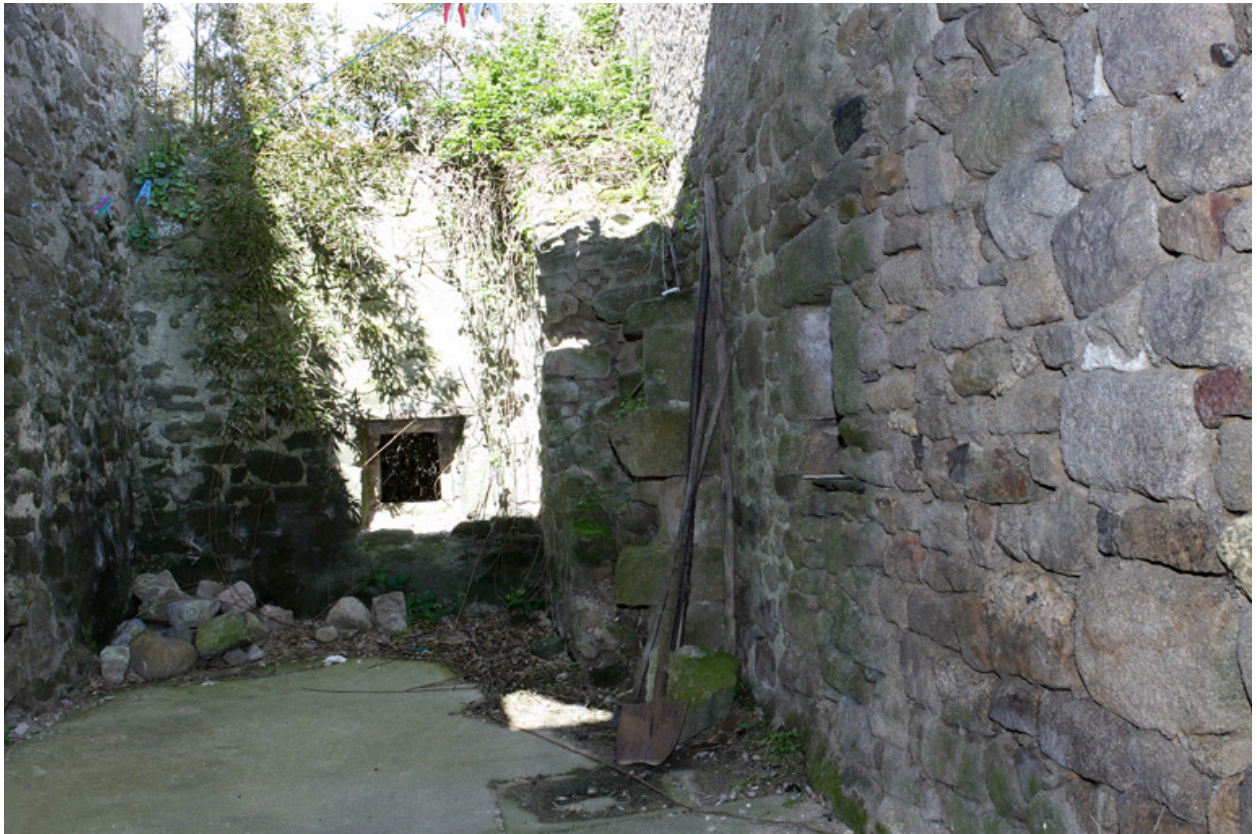
Dépendances. Parties ruinées. Vue depuis l'est.
