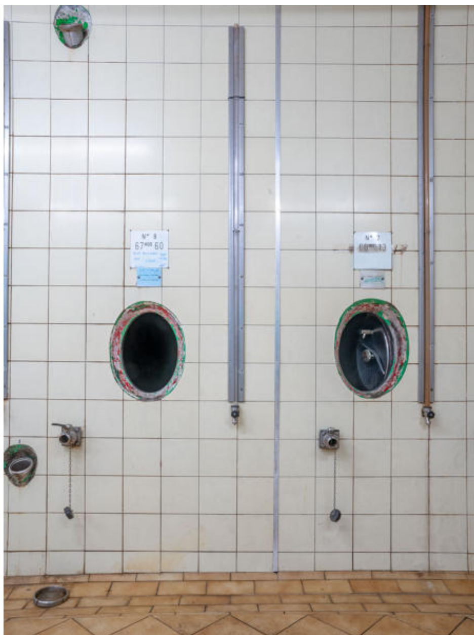
Cuves aériennes, nord-est.
