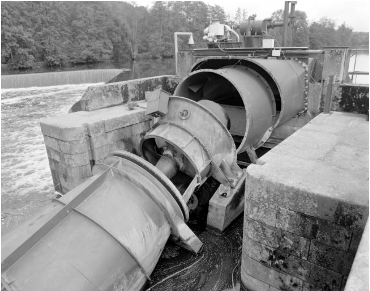
Le siphon, la turbine et le générateur de la centrale hydroélectrique.
