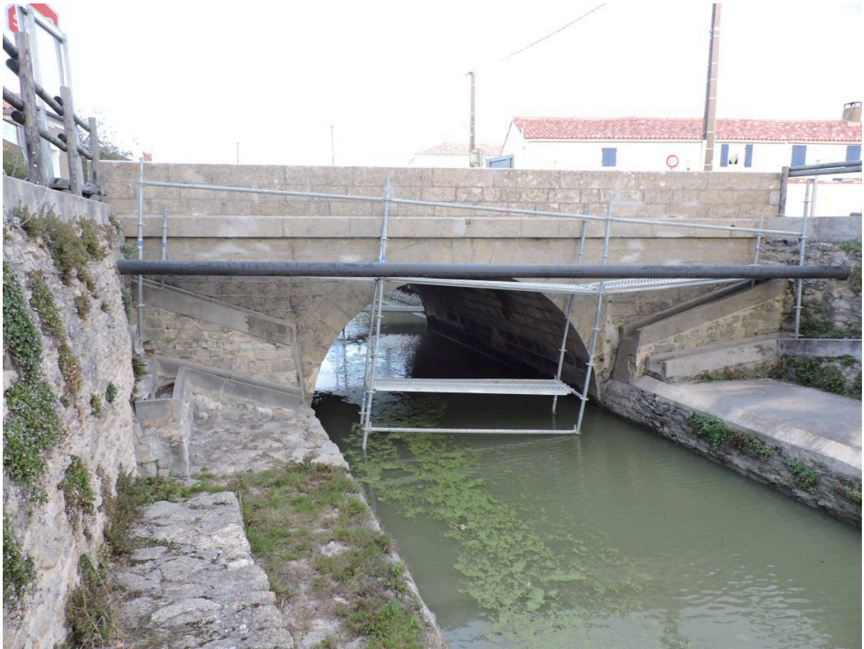
Le pont vu côté aval, depuis le sud-ouest, avant surélévation de ses parapets en 2018.
