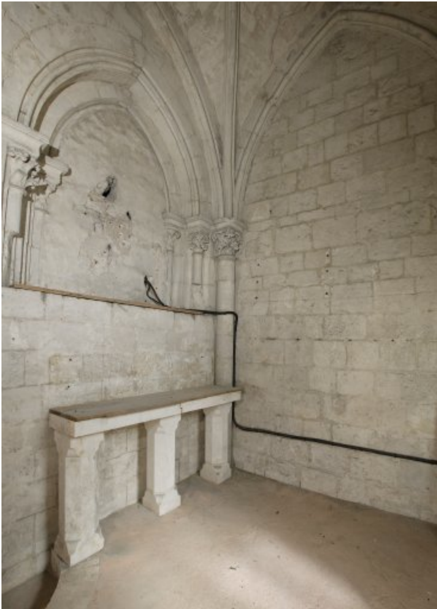
Chapelle orientée du bras sud du transept (fermée et divisée au XVe) : salle à l'étage, prise vers l'est.
