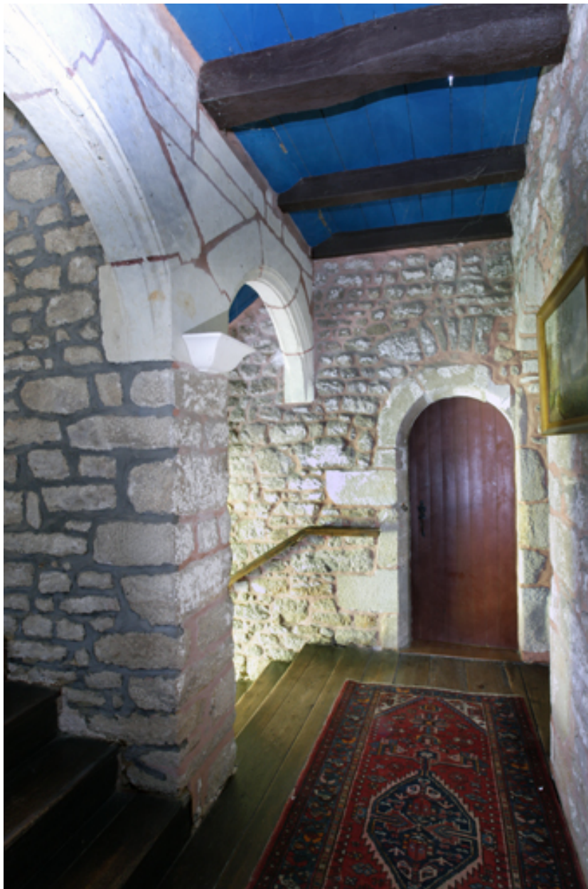
Logis. Cage d'escalier. Premier palier. Vue de la porte ouvrant sur la chambre nord-ouest.
