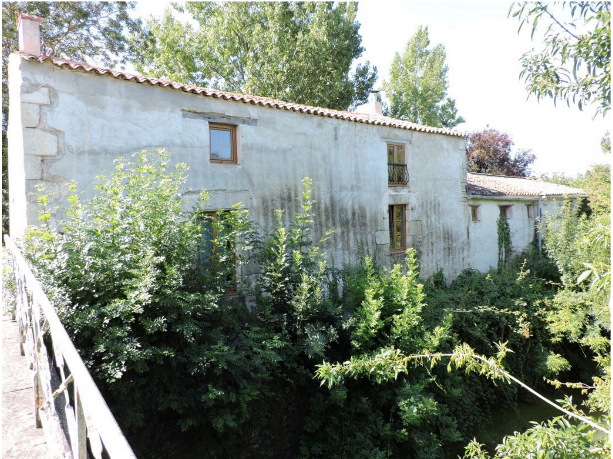
La hutte vue depuis le nord-est, en surplomb du canal de Vix.
