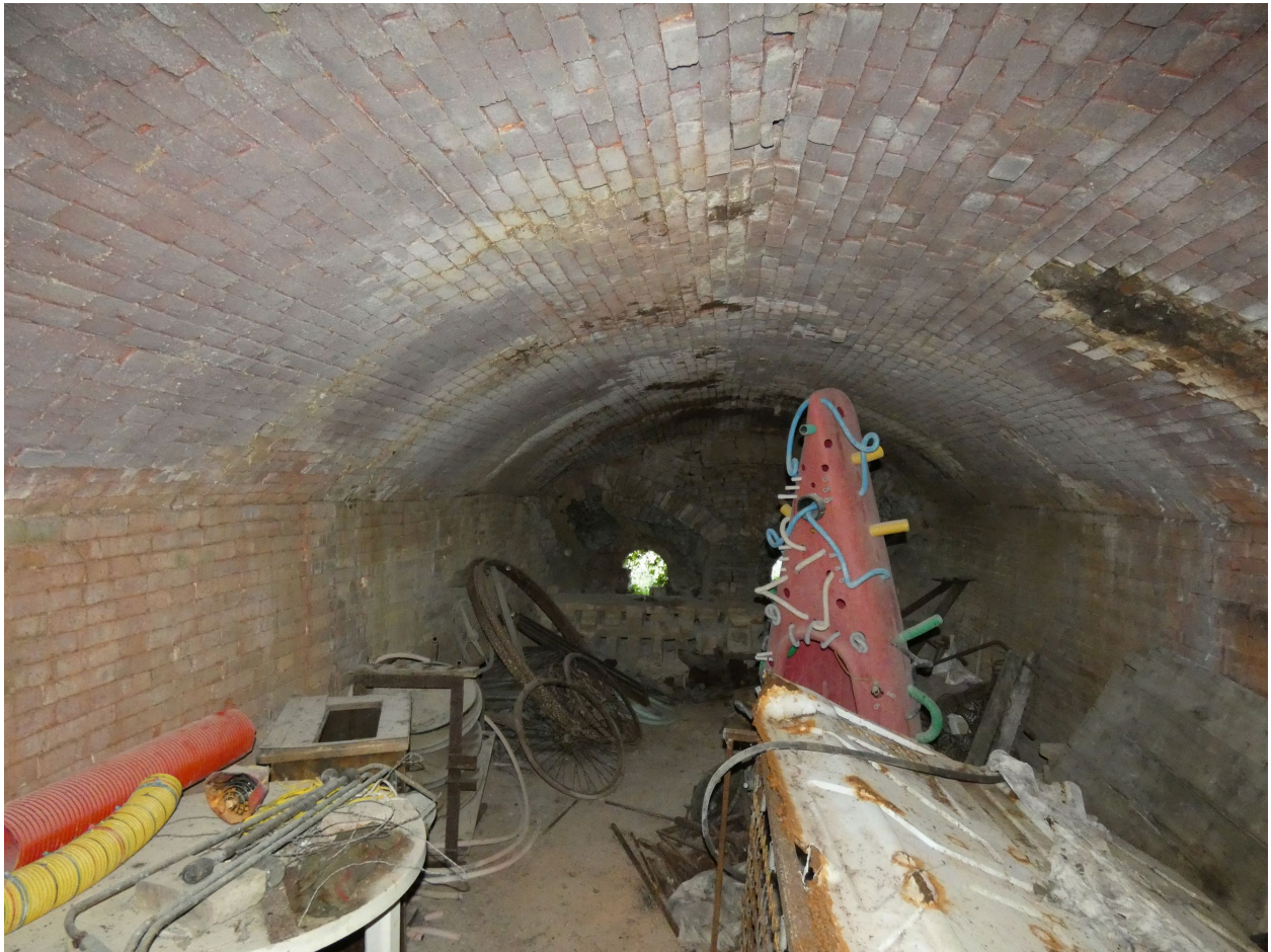
La chambre de cuisson du second four, vue depuis le sud.
