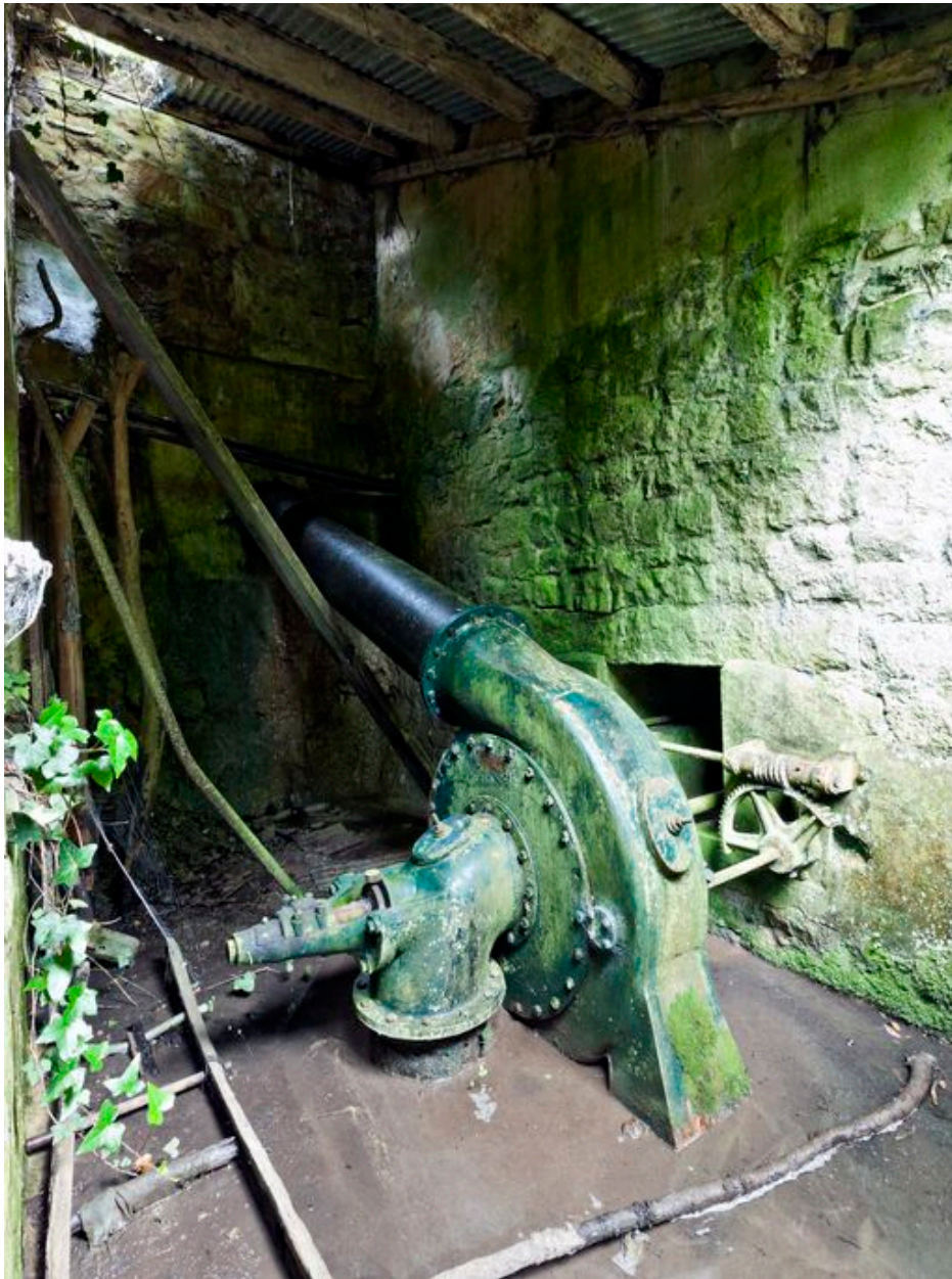
La turbine hydraulique
