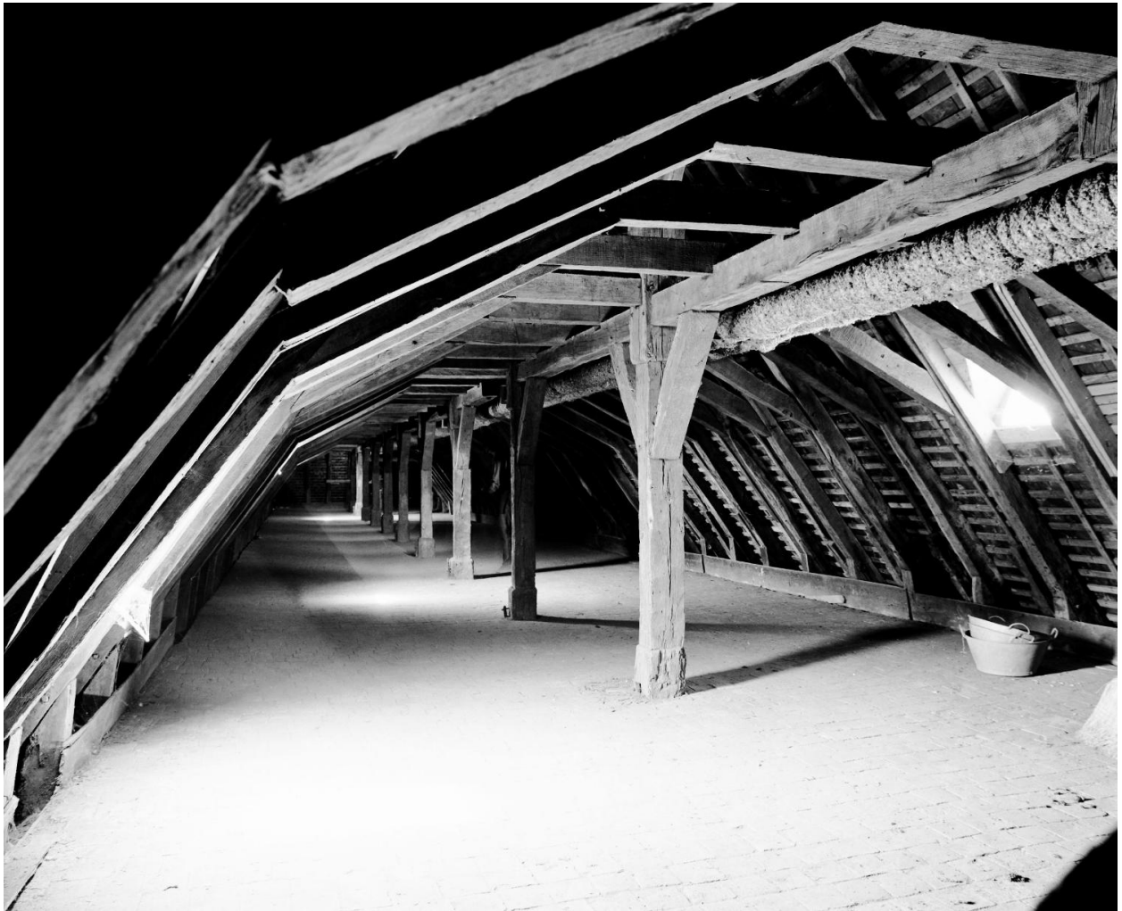
Aile est du cloître (aile du réfectoire), 2e niveau du comble : vue d'ensemble de la charpente, en axe nord-sud.
