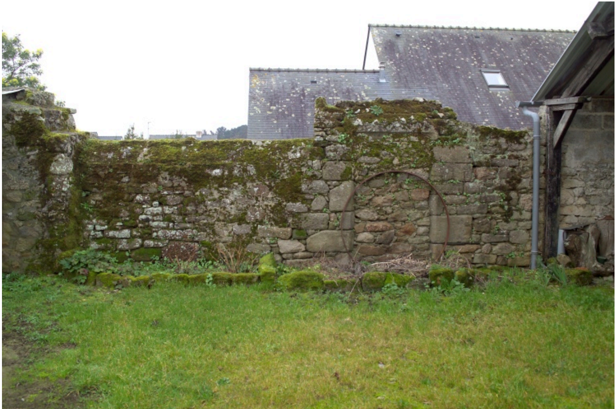
Porte murée dans le mur séparant les parcelles AH 360 et AH 219, vue vers le Sud.
