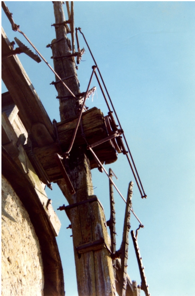
Détail de la tête de l'arbre, avec la tringlerie d'ouverture des ailes Berton. Josick Lancien, septembre 1990.
