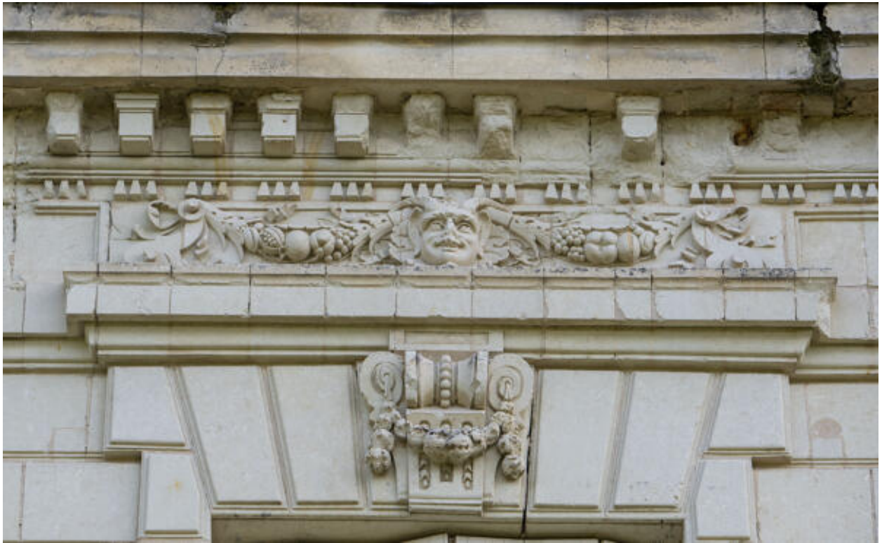
Un détail d'un linteau, d'une agrafe et de la corniche de l'élévation antérieure.
