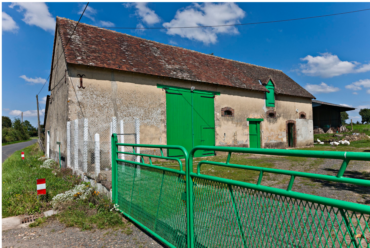
Maçonnerie enduite de la grange-étable du Petit Tronchet.
