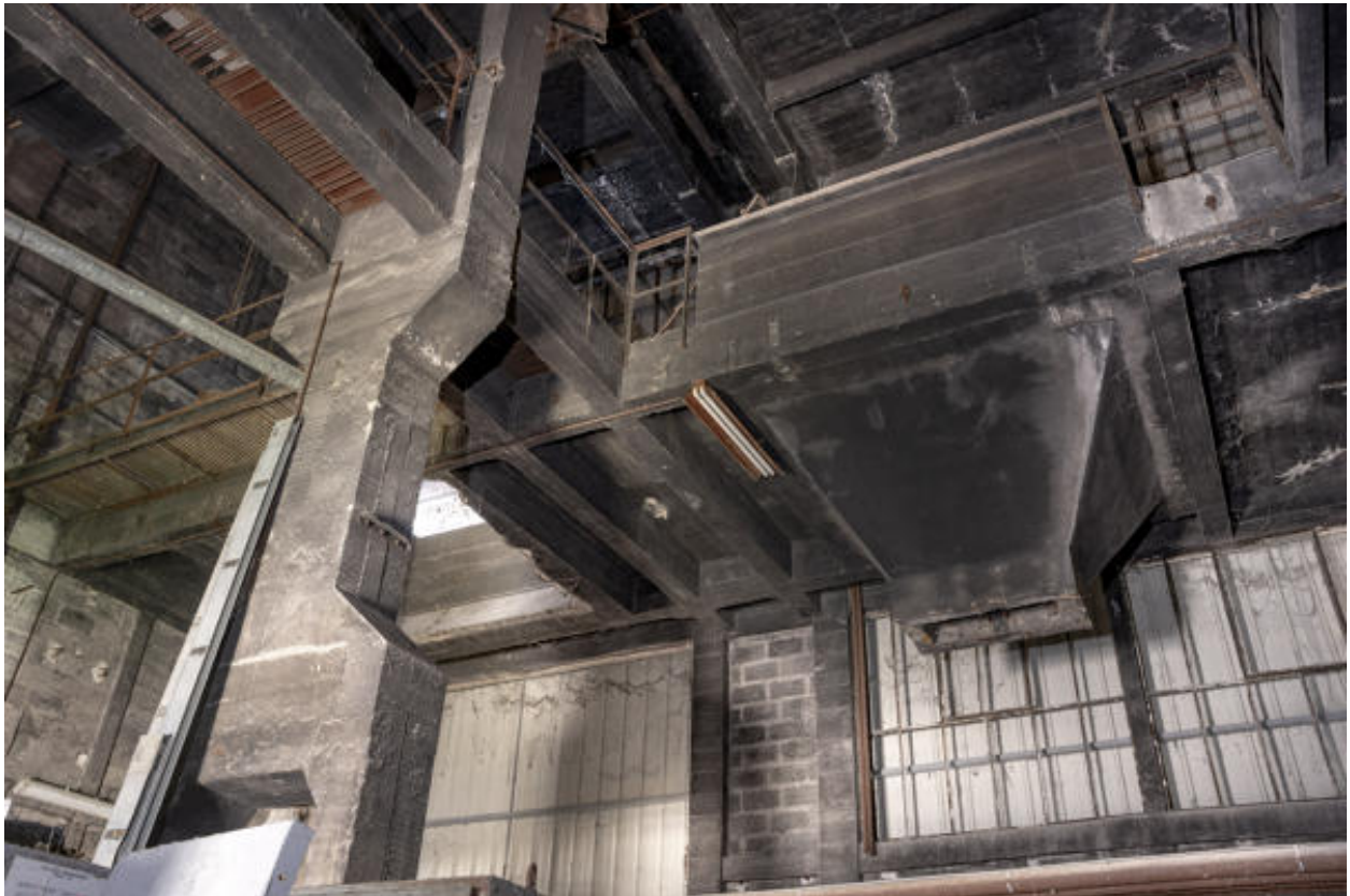
Trémies de béton armé de la chaufferie G de l'usine de papeterie.
