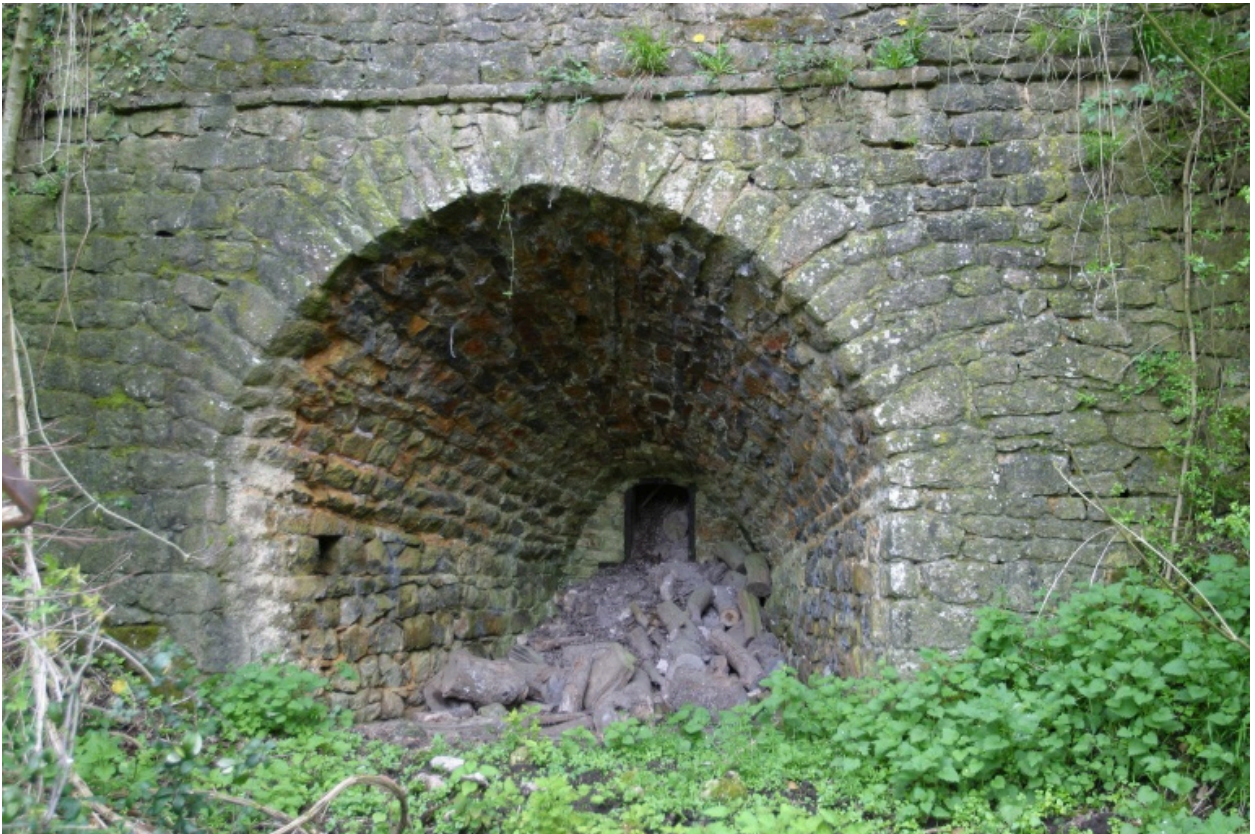
L'ouverture de déchargement du second four.
