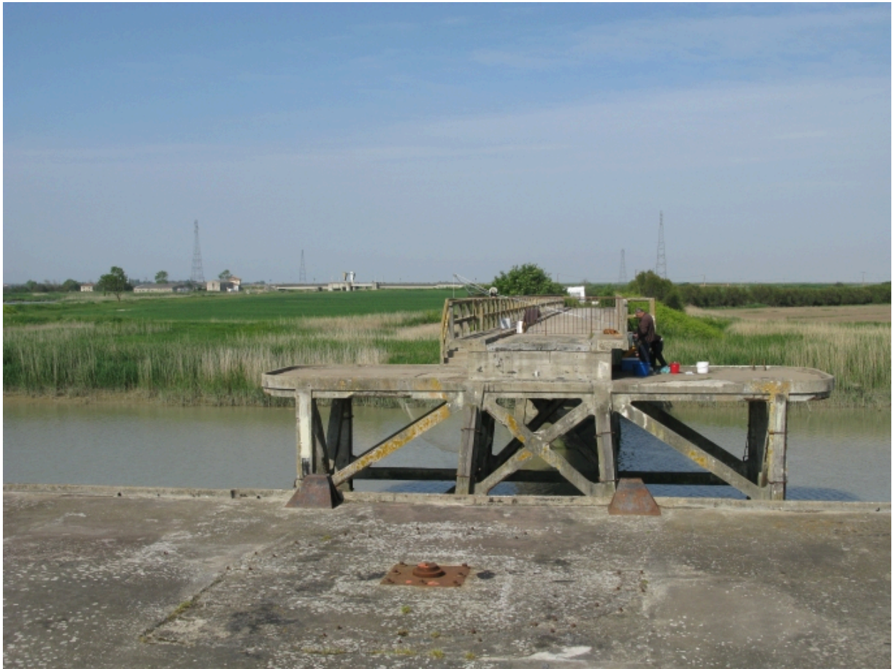
Le pont vu depuis l'est, rive gauche, en 2010, avant la construction de la passerelle.
