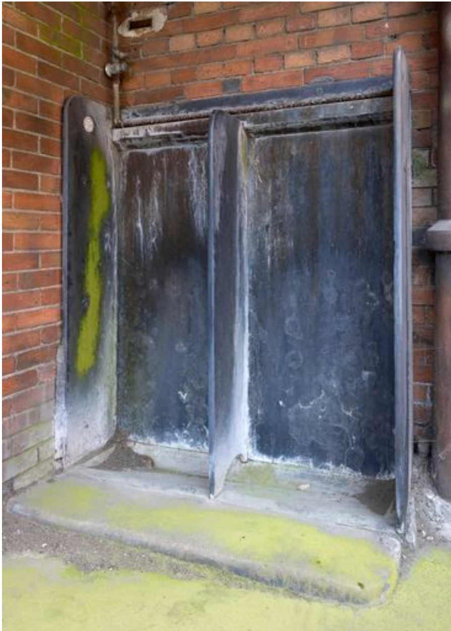
Urinoirs en ardoises des Ardoisières d'Angers.
