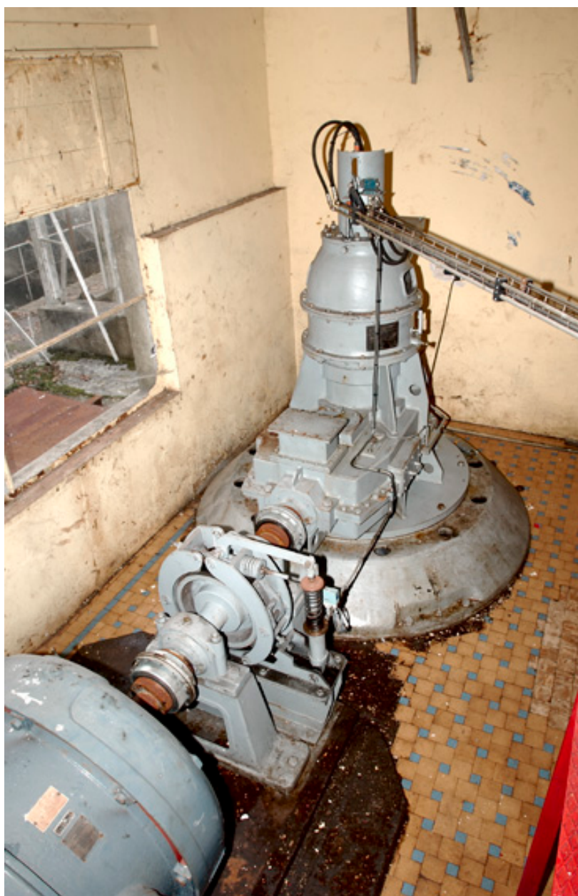
Turbine hydraulique, produisant une partie de l'électricité nécessaire au site.
